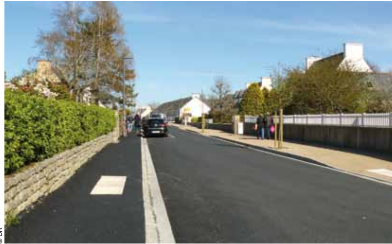
Le revêtement des trottoirs et de la chaussée a été entièrement repris et les places de stationnement ont été réaménagées.
