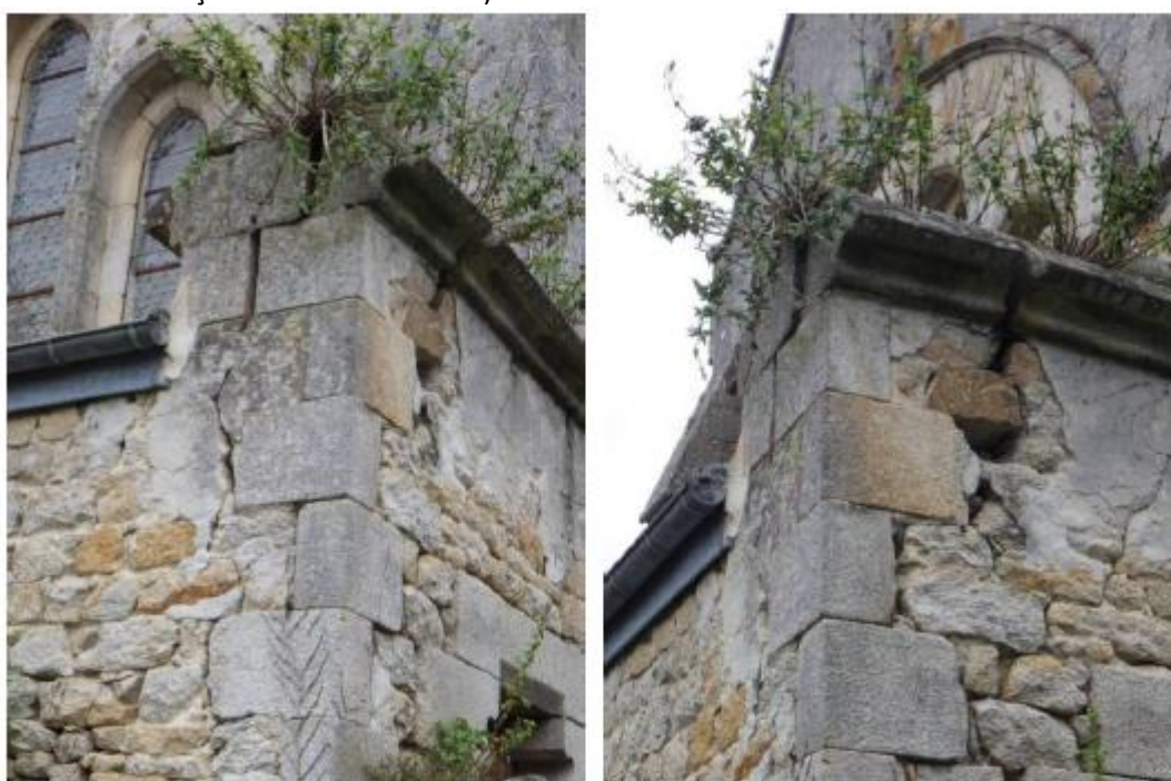
L'angle Sud Ouest du narthex est largement fragilisé
